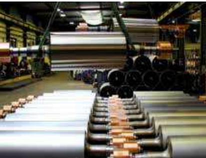
Rouleaux conducteurs pour ligne d'étamage électrolytique
