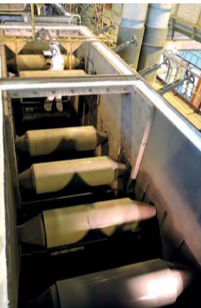
Kontrolle von Heizwalzen
