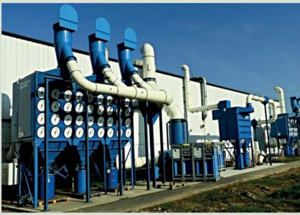
PMG OUEST COATING : air filtration system.
