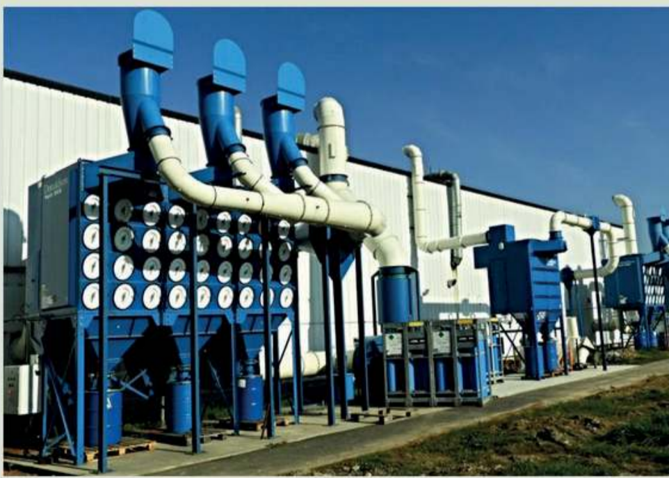
PMG OUEST COATING : air filtration system.
